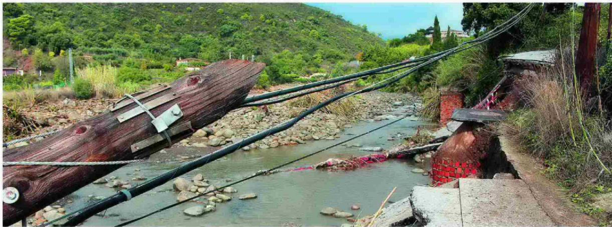
En la imagen los destrozos causados por el temporal hace unos días en el camino de Forest Hills tras el desbordamiento del río Padrón, en la localidad malagueña de Estepona
