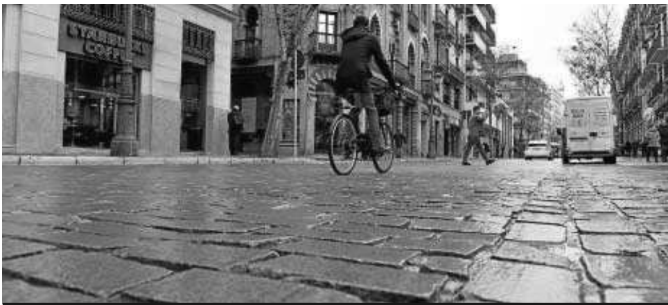
La Campana. Cuenta también con un adoquinado plano y gris que sustituyó al de Gerena durante el mandato municipal de Juan Ignacio Zoido. Tuvo que ser reparado al poco tiempo por problemas en su colocación.
