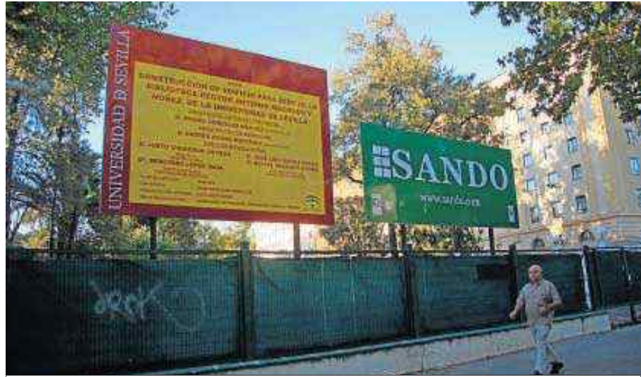
Valla que delimita el solar donde se construye la nueva biblioteca universitaria.
