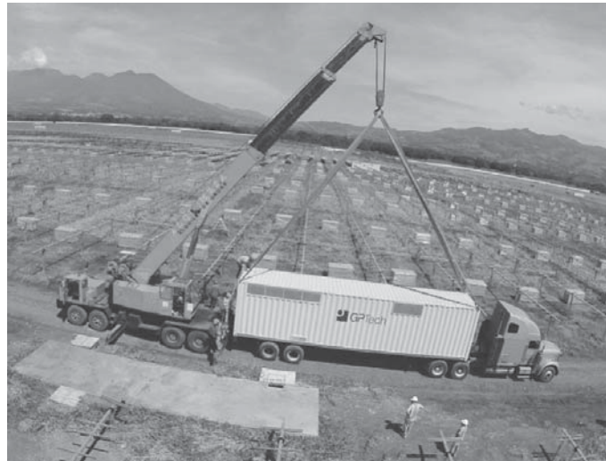
Imagen de los equipos de GPTech en Guatemala. CEDIDA
