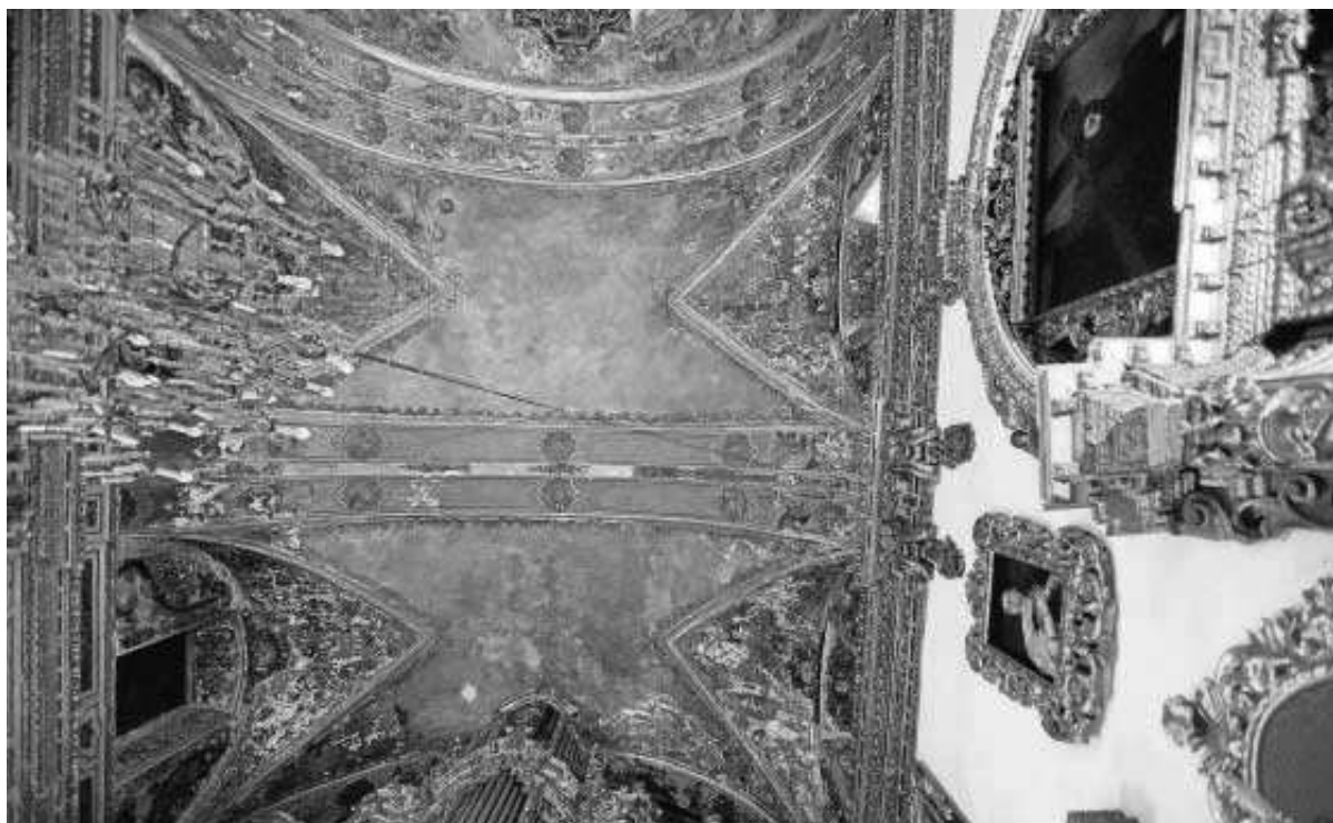
Aspecto que presentan las pinturas murales de la bóveda, muy ennegrecidas y con importantes pérdidas.
