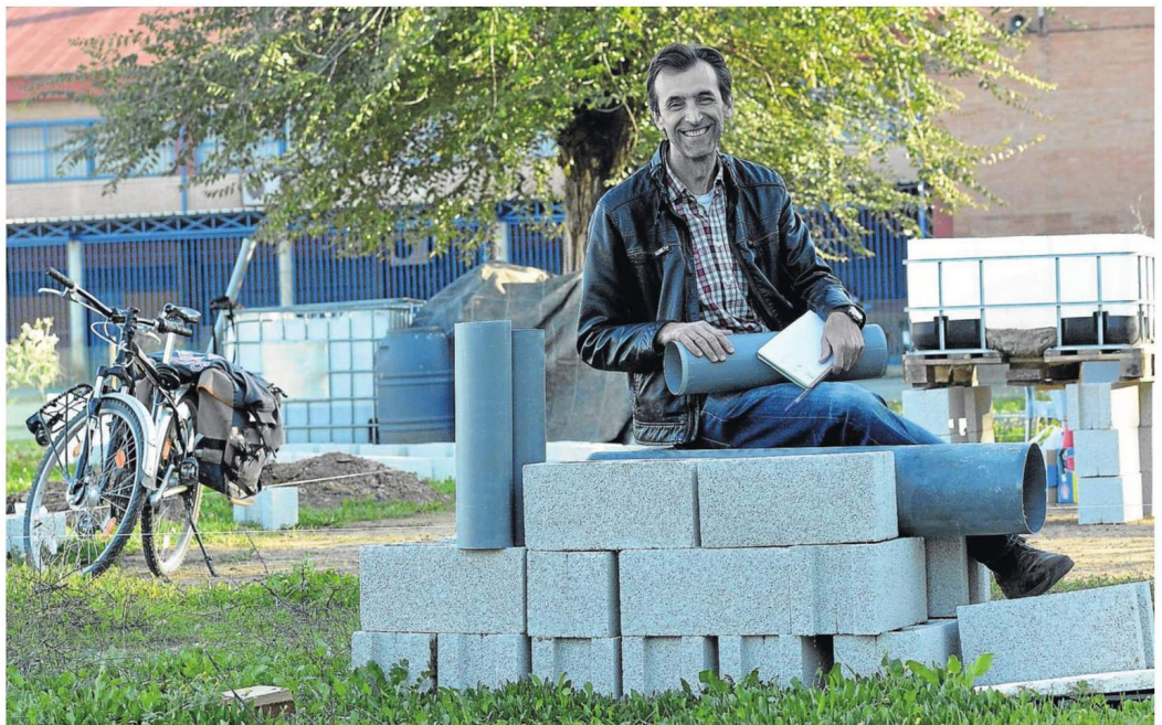
José Lobillo, junto a la instalación de acuaponía que se construye dentro del IES Romero Murube. / Manuel Gómez
