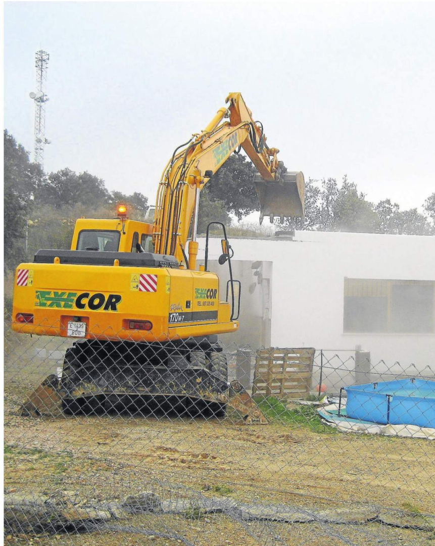
Una excavadora derriba una vivienda declarada ilegal en Córdoba, en 2007. / El Correo
