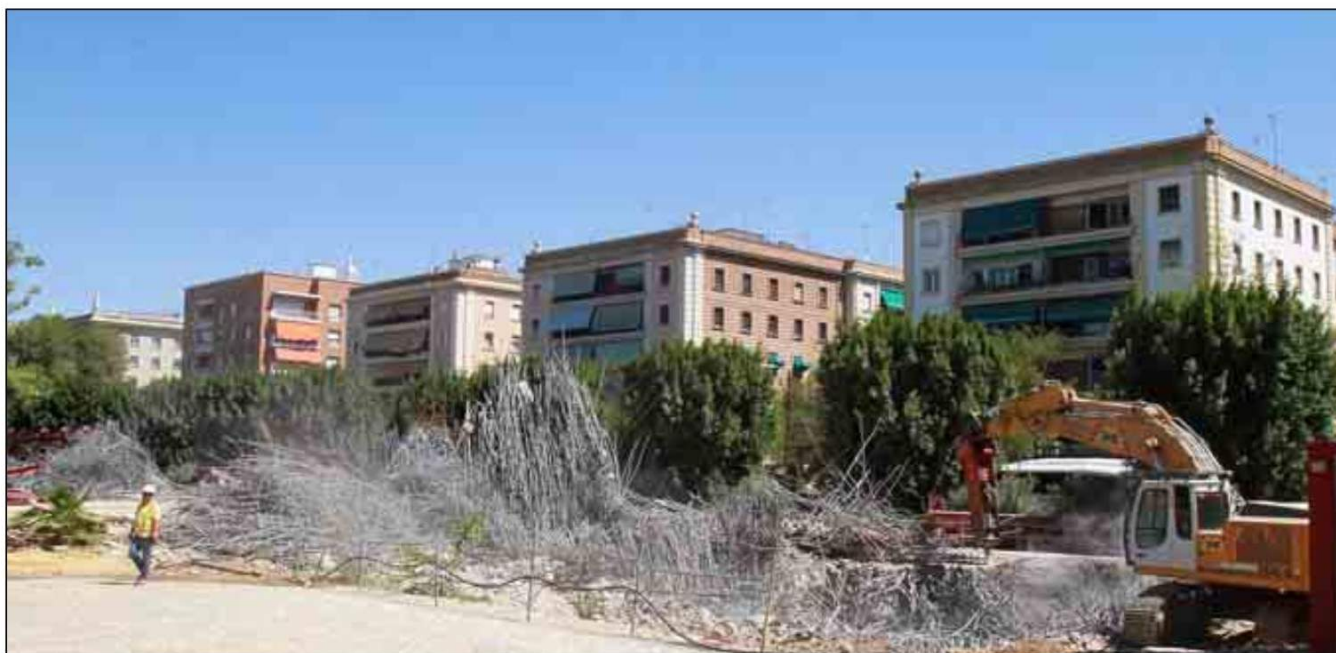
Obras de demolición de la estructura de la biblioteca del Prado, en septiembre de 2012. / CARLOS MÁRQUEZ
