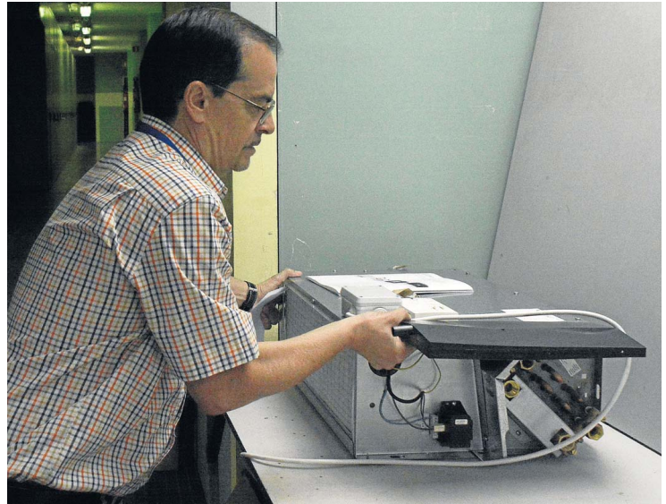
Uno de los aparatos Fancoil que se han ido renovando en el hospital Macarena. / Manuel Gómez
