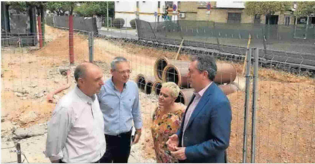
Juan Espadas e Inmaculada Acevedo visitan las obras en la Avenida del Greco junto a Jaime Palop (Emasesa) y otros responsables de los trabajos.
