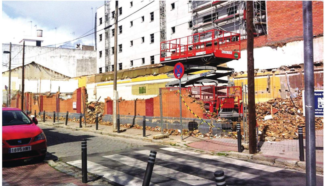
El solar que ocupaba la fábrica de Ballestas, en el estado en el que ha quedado tras el derribo del edificio. / M. Benitez (para culturadesevilla.blogspot.com)
