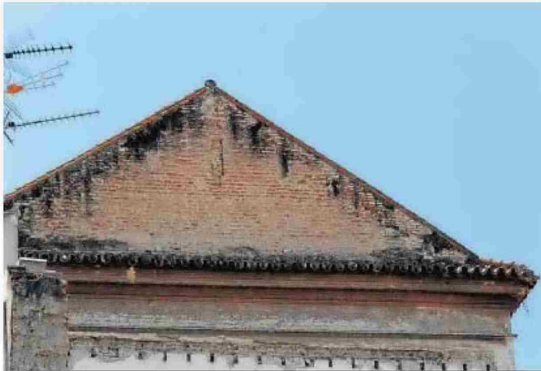
La cubierta es una de las zonas más deterioradas, tiene numerosas tejas rotas y desplazadas.
