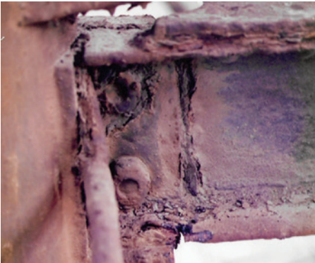
Figura 28. Imágenes del estado del muelle que muestran su deterioro
